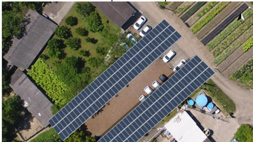
Figura 3 - Estacionamento do Hospital com os painéis fotovoltaicos alocados
